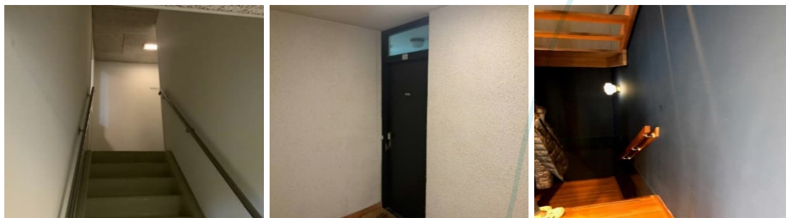
Foto 1: Enige vervuiling, plaatselijk mechanische schade van het muurverfsysteem.
