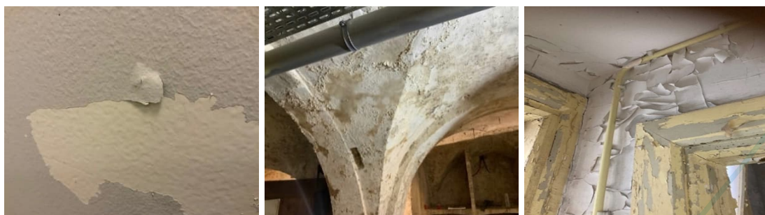
Foto 1: Slechte hechting van het muurverfsysteem.
