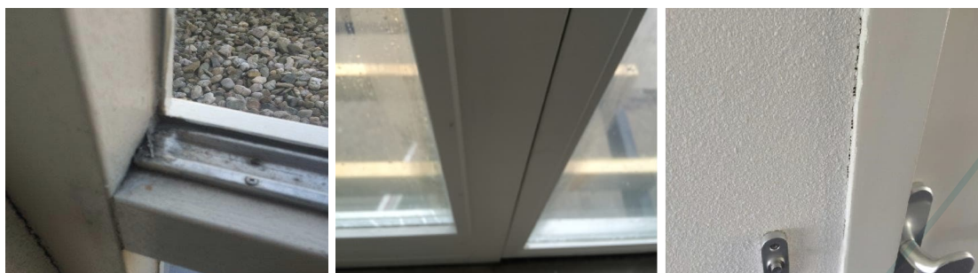
Foto 1: Lichte verschade bij verbindingen en kitvoegen
