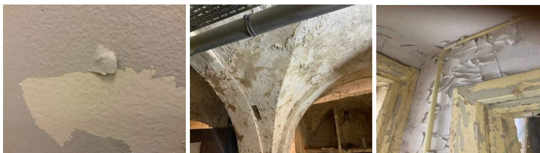
Foto 1: Slechte hechting van het muurverfsysteem.
