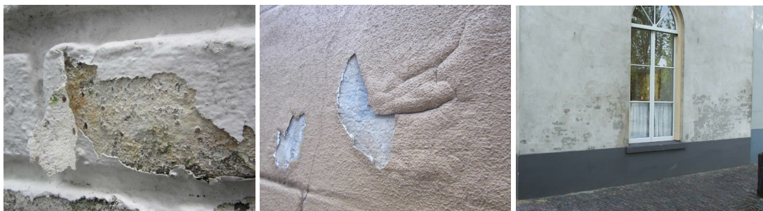
Foto 1: Slechte hechting van het muurverfsysteem.
