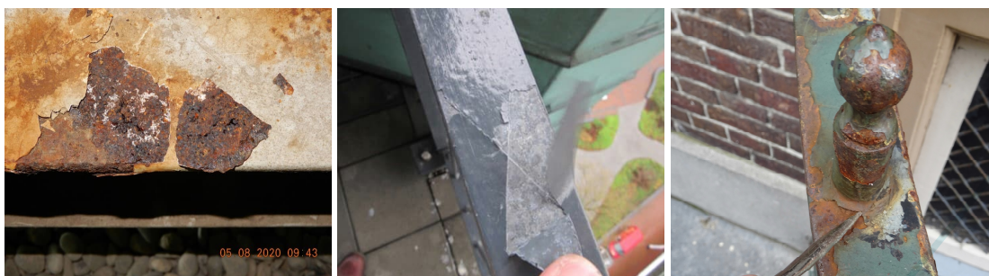
Foto 1: Onthechting, zware roestvorming, putcorrosie.
