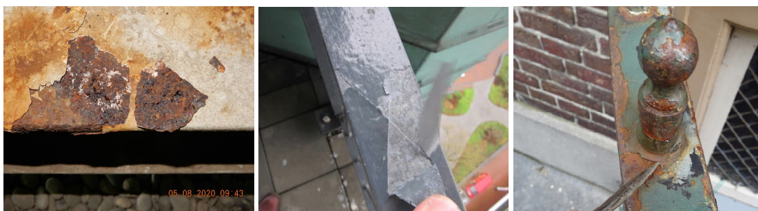
Foto 1: Onthechting, zware roestvorming, putcorrosie.
