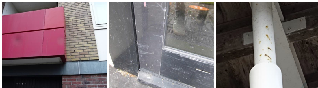
Foto 1: Borstwering balkon, verflagen intact, verkleuring, glansverlies en poederen. Plaatselijk scherpe randen.
