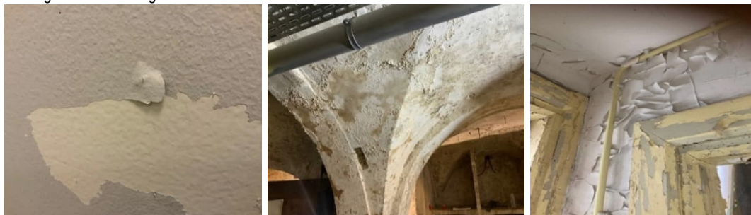
Foto 1: Slechte hechting van het muurverfsysteem.
