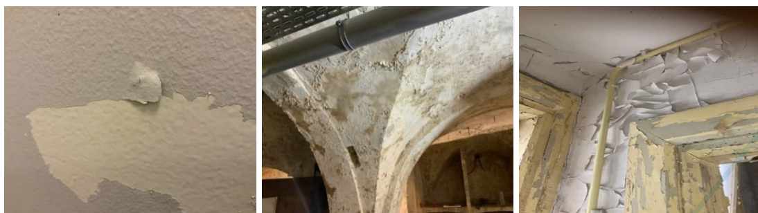
Foto 1: Slechte hechting van het muurverfsysteem.
