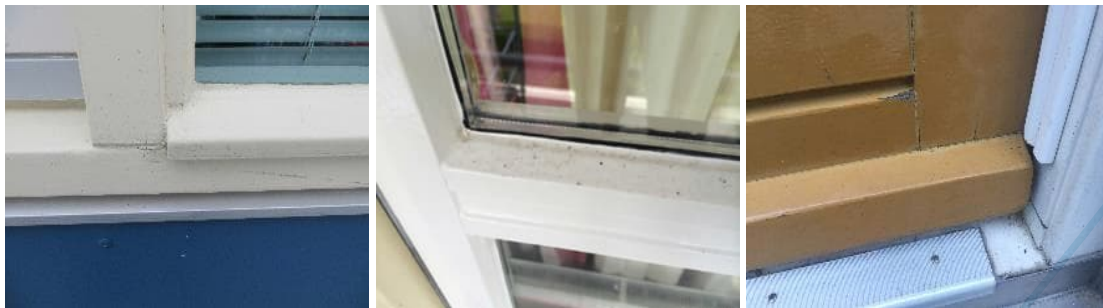
Foto 1: Lichte verschade bij verbindingen en kitvoegen
