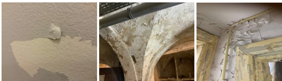
Foto 1: Slechte hechting van het muurverfsysteem.
