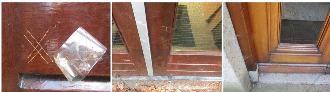
Foto 1: Verfsysteem intact, goede hechting, Geen verweerde delen onder laklagen.
