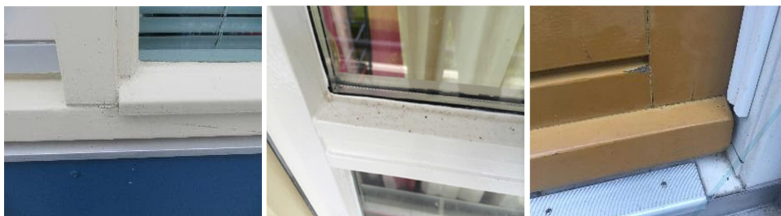
Foto 1: Lichte verschade bij verbindingen en kitvoegen
