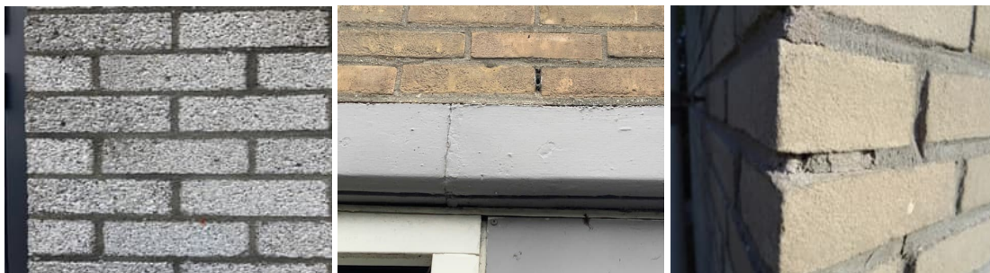
Foto 1: Onbehandelde grove betonsteen, lichte vervuiling.
