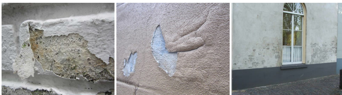
Foto 1: Slechte hechting van het muurverfsysteem.
