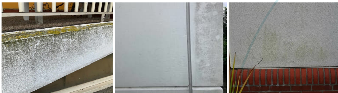
Foto 1: Diktekanten met veel mos-en alg vervuiling, verfsysteem heeft plaatselijk schade.
