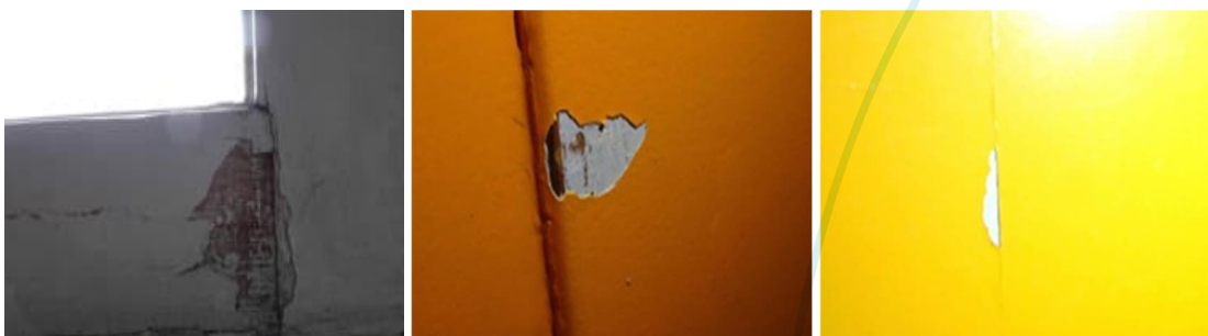
Foto 1: Versteende verflagen. Openstaande verbinding en springlagen. Scheurvorming.
