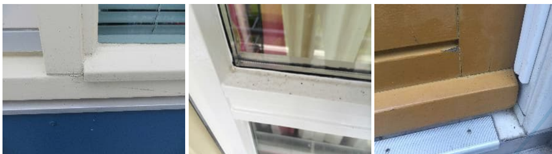
Foto 1: Lichte verschade bij verbindingen en kitvoegen
