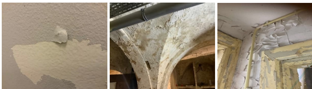
Foto 1: Slechte hechting van het muurverfsysteem.
